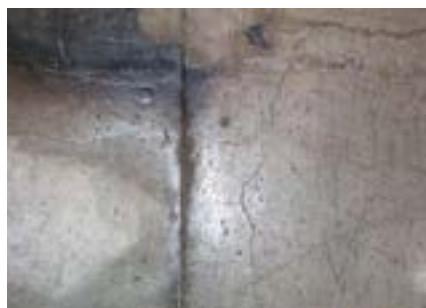
Рис. 2. Усадочные трещины на поверхности стены автодорожного тоннеля
