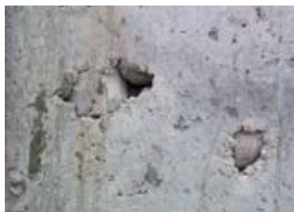
Рис. 1. Зависание бетонной смеси в зоне «сухарей»
