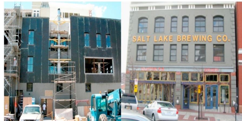
Сейсмоусиление здания (США, штат Юта)
