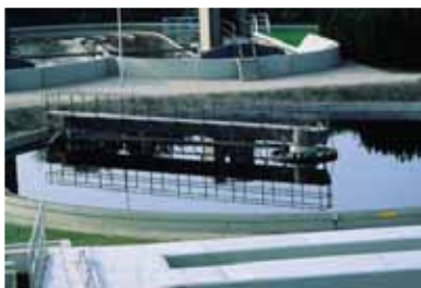
Технические резервуары спец. назначения
