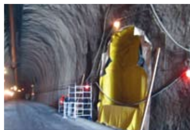
ЮГСК 1-й тоннельный комплекс, Сочи (Россия)
