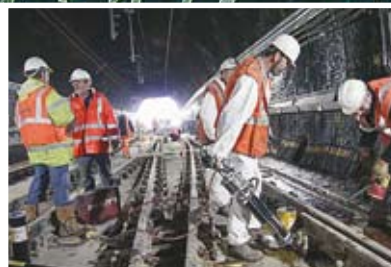
Эластичное крепление рельс в туннеле (Швейцария)
