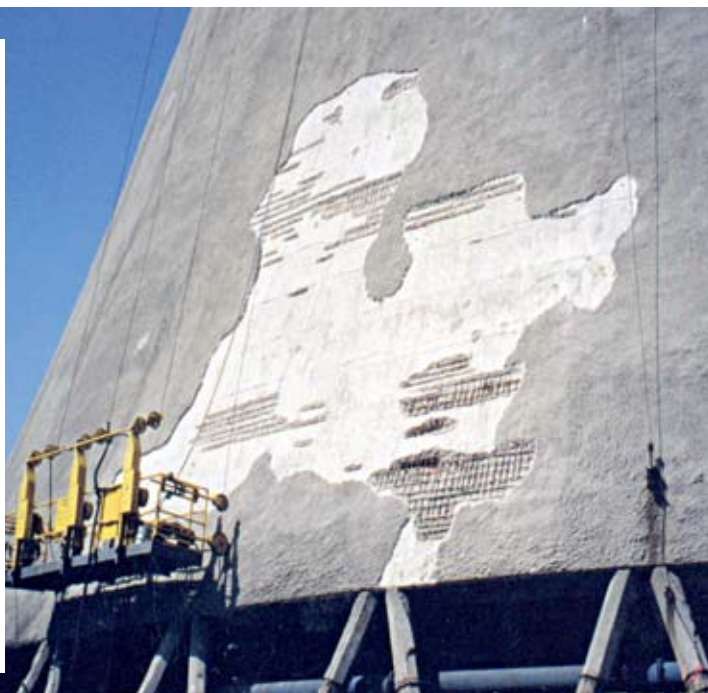
Разрушение поверхности градирни, вызванное карбонизацией бетона.
