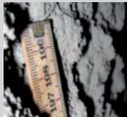
Точечная нагрузка Разрушение поверхности бетона
