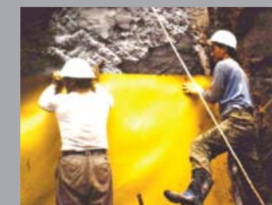
Игнорирование требований, предъявляемых к основанию – не уложены защитные материалы
