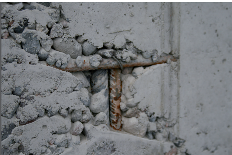
фото 22 Открытые арматурные стержни в бетоне
