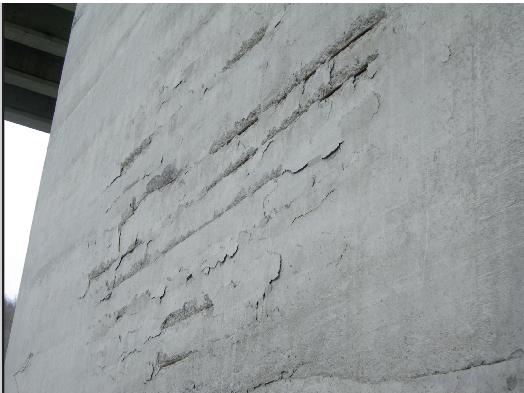
фото 4 Разрушение сооружения вследствие коррозии арматурных стержней
