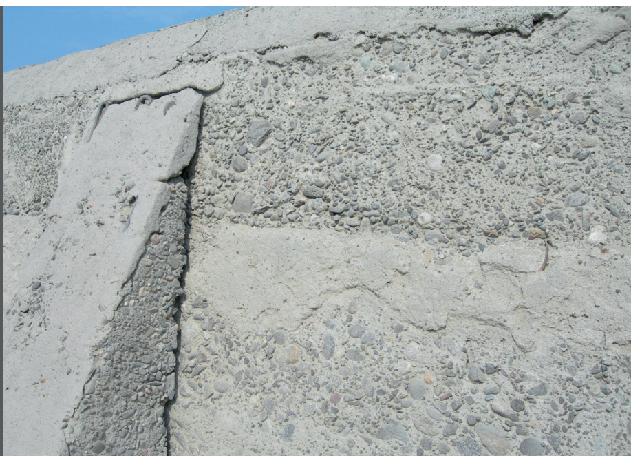
фото 5 Влияние на поверхность бетона выщелачивания
