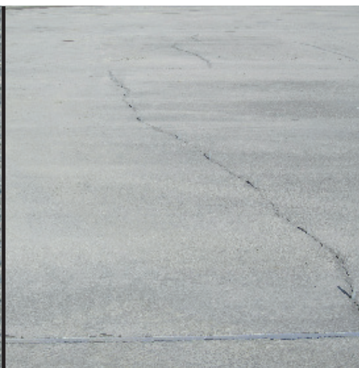
фото 16 Трещина в бетоне
