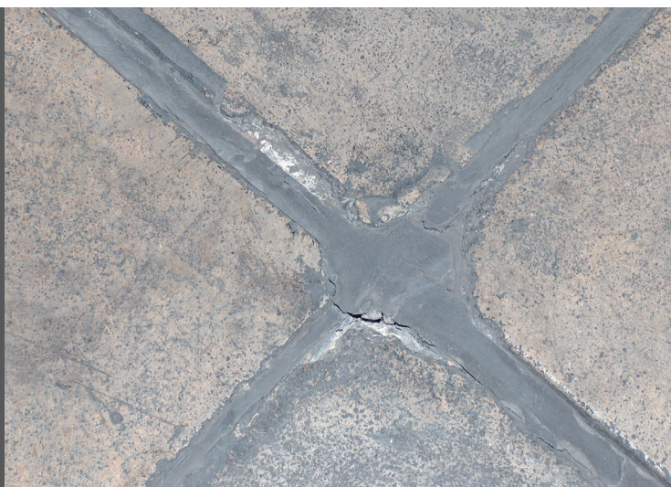
фото 19 Пример разрушения в стыках
