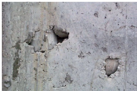
Рис. 1. Зависание бетонной смеси в зоне «сухарей»
