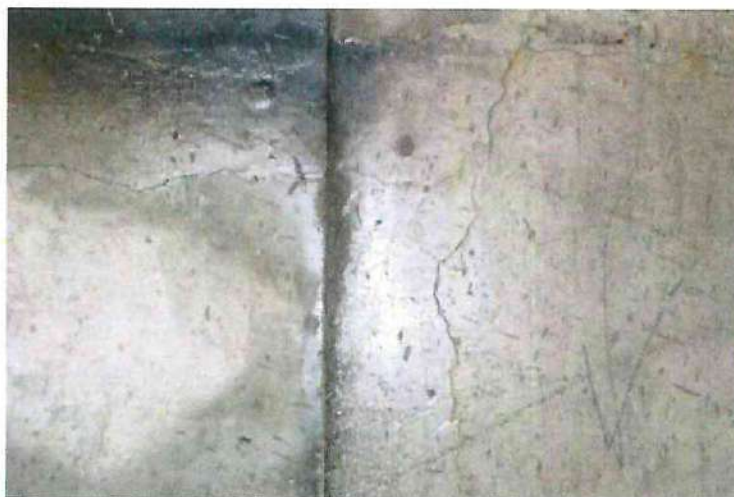
Рисунок 6.5 – Усадочные трещины на поверхности стены
