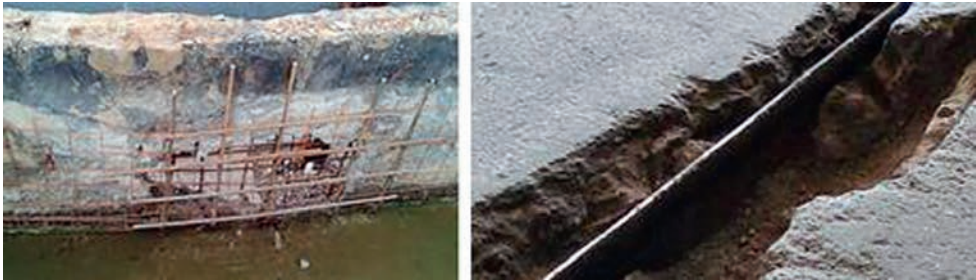
Рисунок 6.3.5.1 – Объемные разрушения бетона
