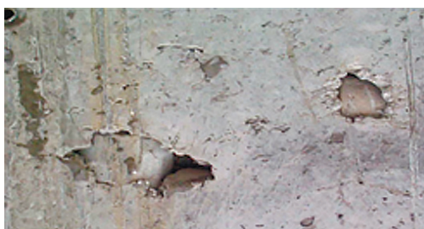
Полости от зависания бетонной смеси
