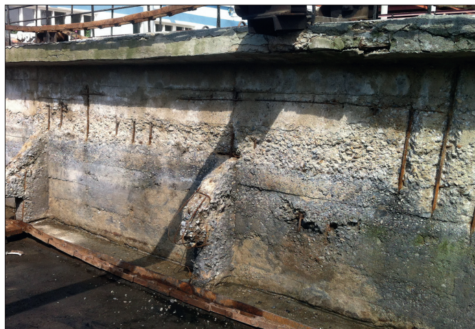
Рисунок 4 – Разрушенные участки бетона с оголенной арматурой
