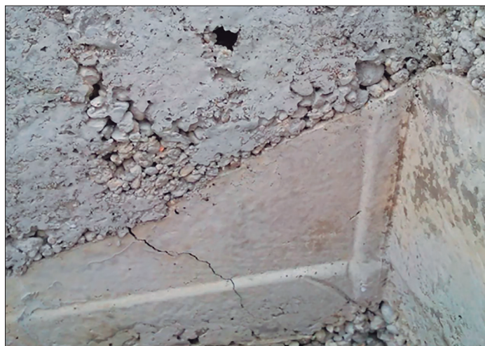
Рисунок 3 – Поверхностные дефекты бетона
