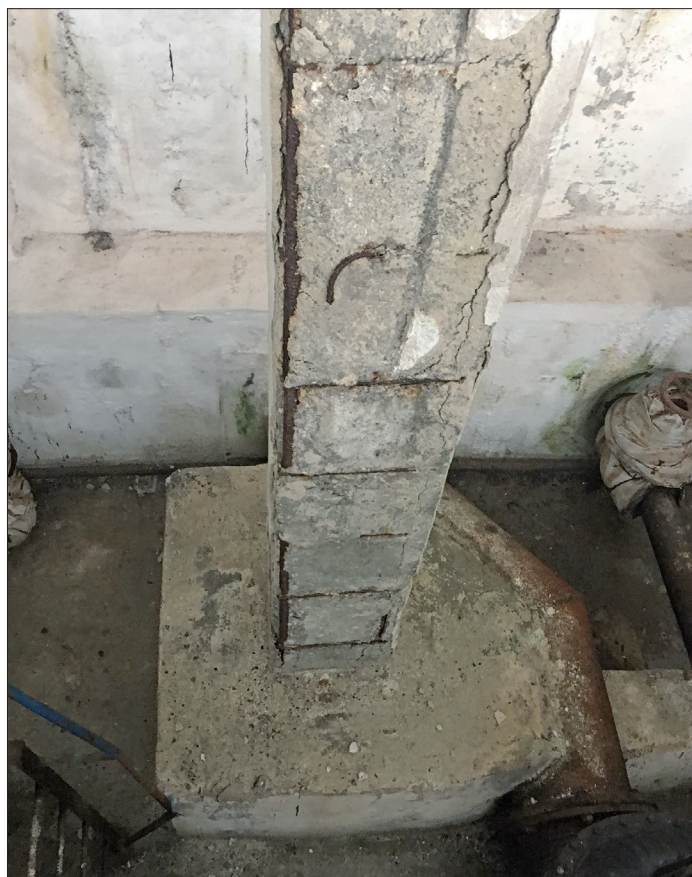
Рисунок 7 – Несущие железобетонные колонны с поврежденным защитным слоем бетона и участками оголенной арматуры
