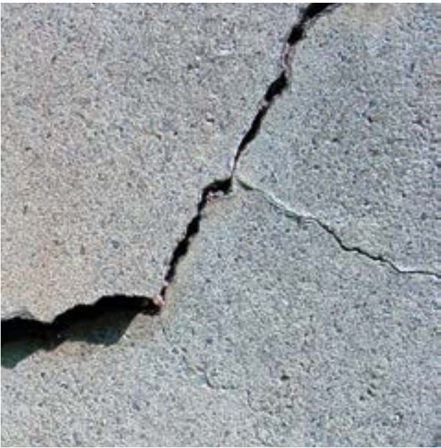
Рис. 16. Трещина в бетоне
