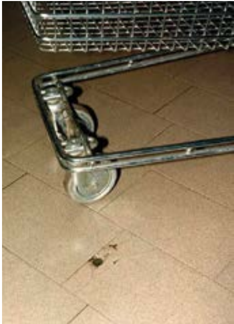
Плитка, поврежденная под действием повышенной нагрузки
