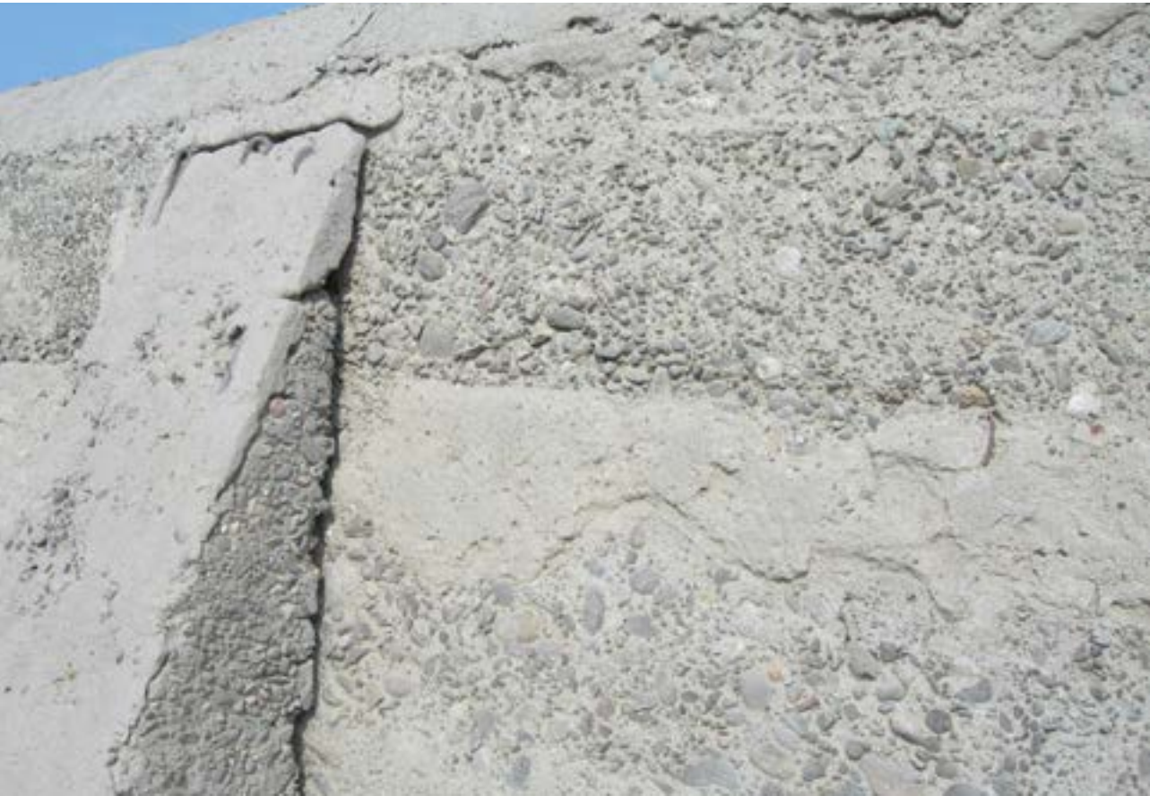
Рис. 6. Влияние выщелачивания на поверхность бетона
