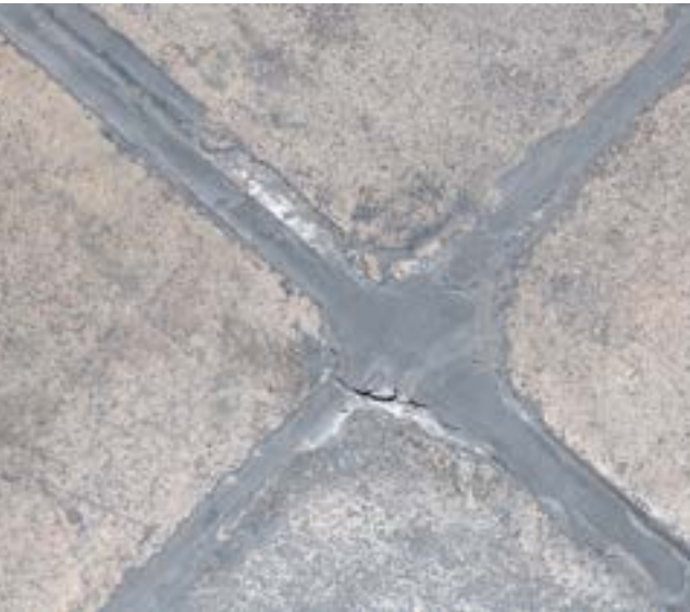
Рис. 19. Пример разрушения в стыках
