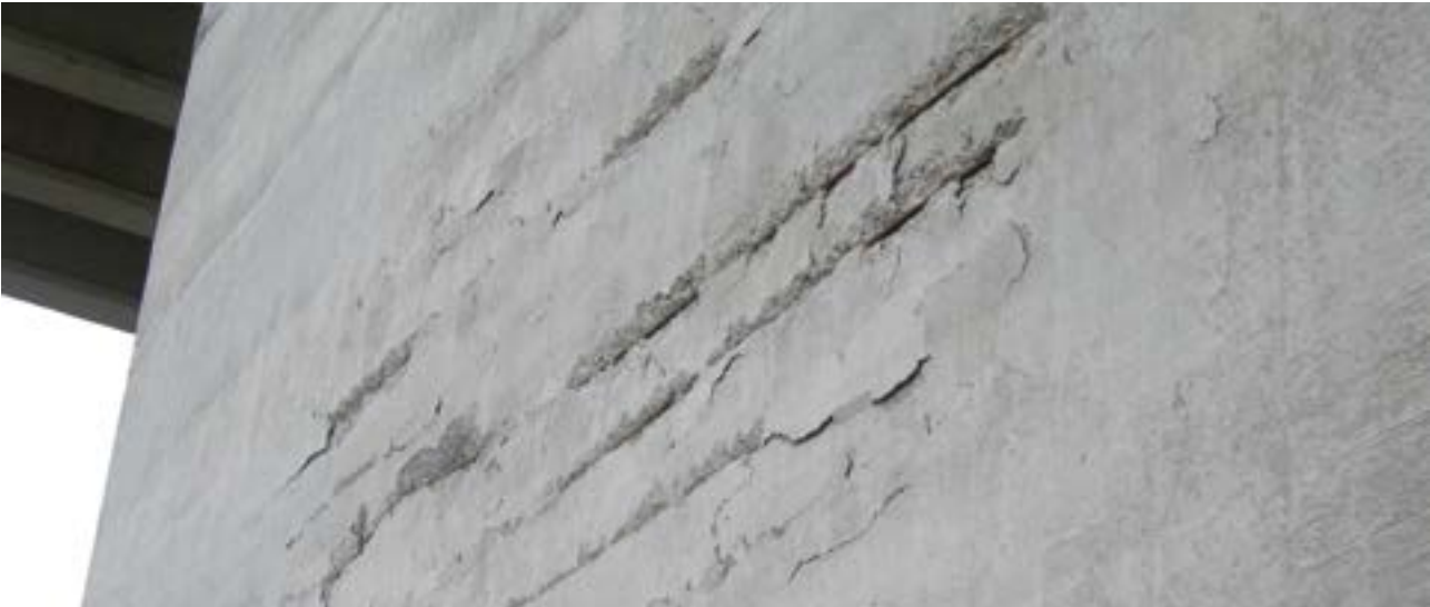
Рис. 4. Разрушение сооружения вследствие коррозии арматурных стержней
