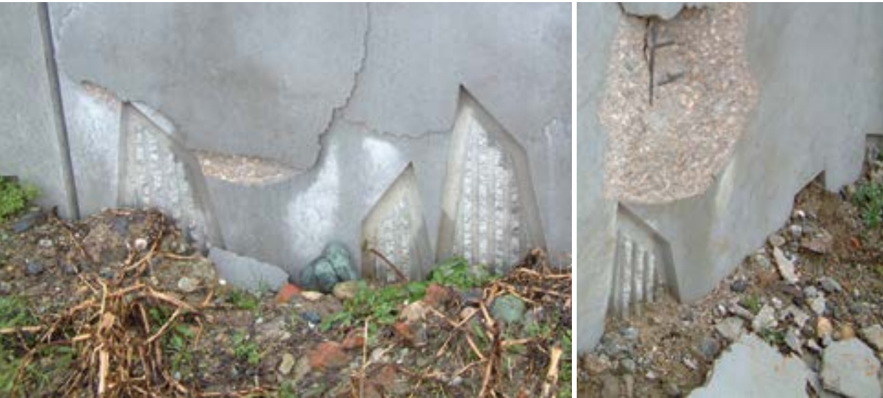
Рис. 14. Разрушение, вызванное циклами замораживания/оттаивания
