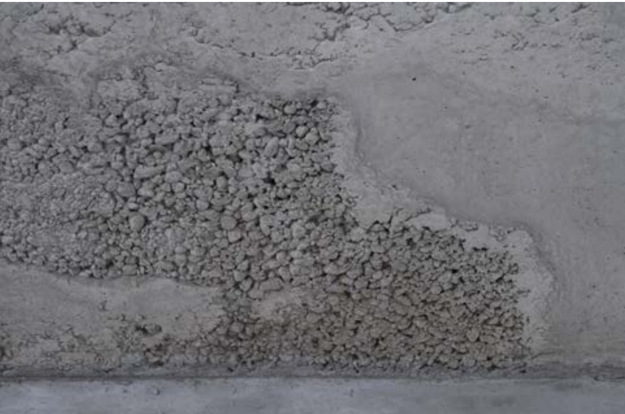
Рис. 21. Разделение заполнителей в бетоне
