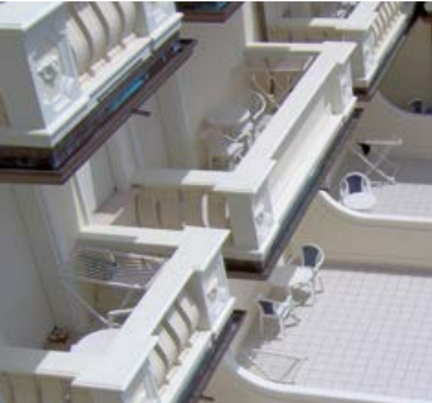
Решение 1. Гидроизоляция террас и балконов
