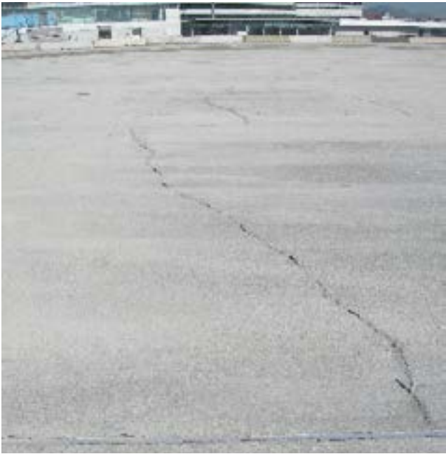
Рис. 17. Трещина в бетонной плите
