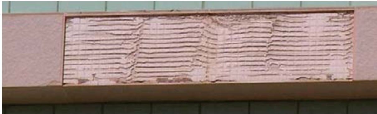
Следствие укладки плитки в ветреную погоду: пленка, образовавшаяся на поверхности клея, препятствует адгезии
