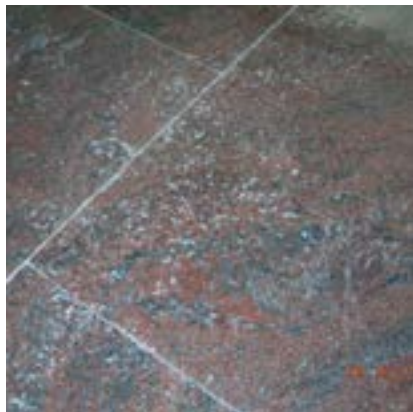
Пример высолов по причине подъема влаги из основания
