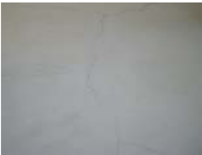
Трещины на поверхности стяжки
