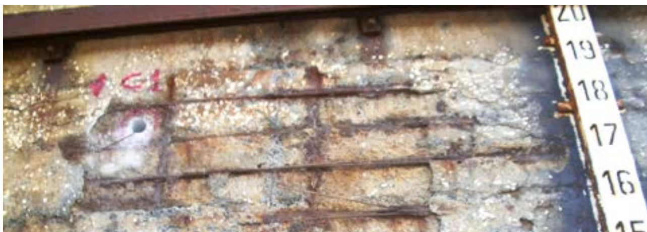
Рис. 10. Коррозия в результате воздействия хлоридов
