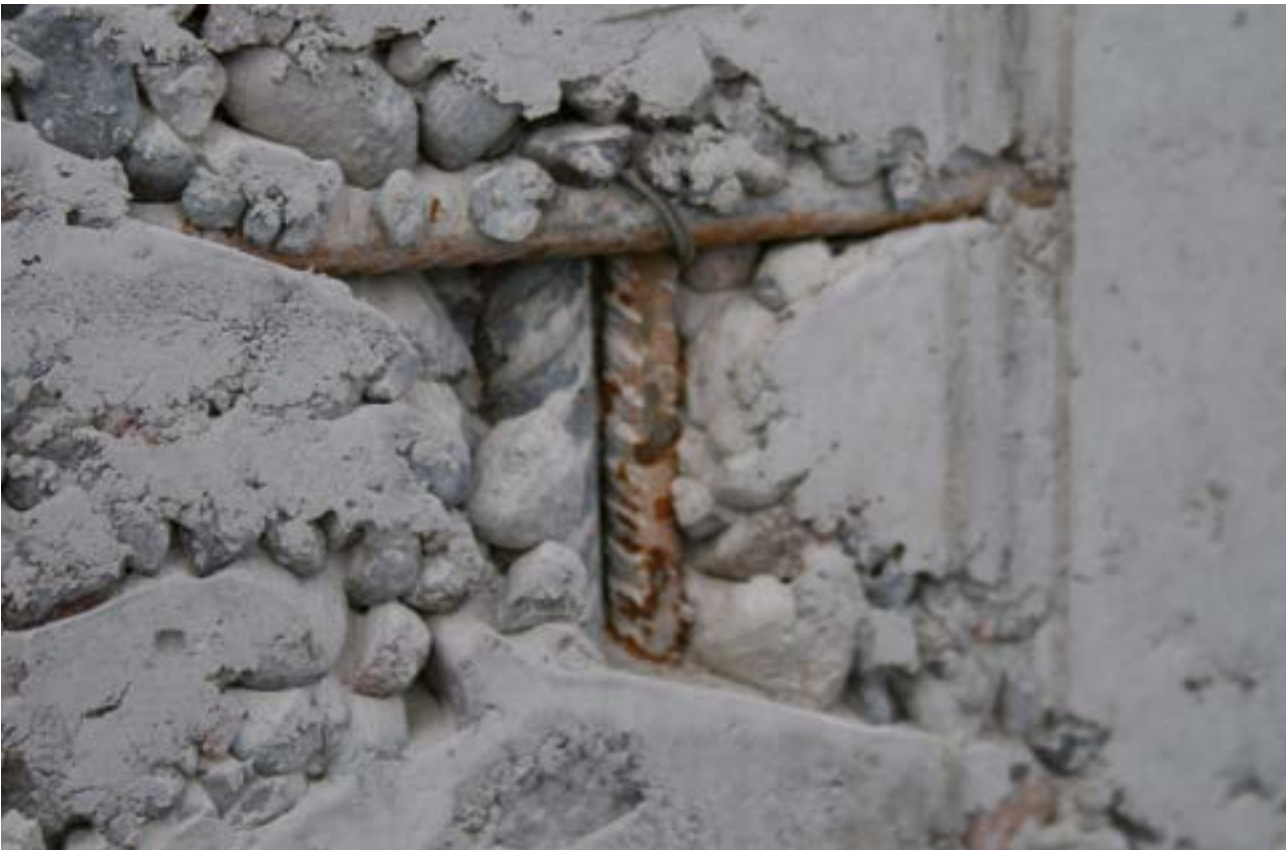
Рис. 22. Открытые арматурные стержни в бетоне
