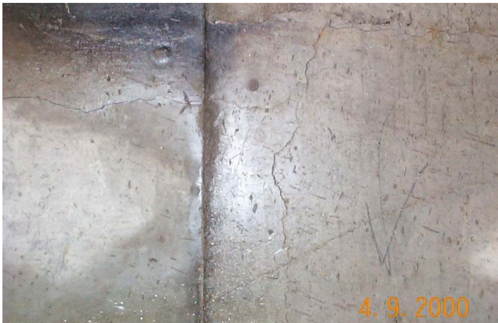
Рис. 6. Усадочные трещины на поверхности стены секции № 8 автомобильного тоннеля
