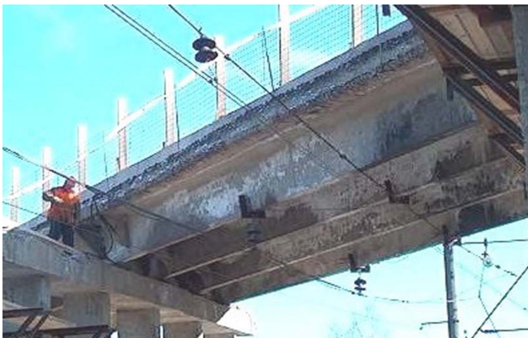
Рис. 7. Разрушение бетона пролетного строения
