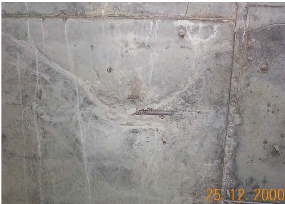
Рис. 1. Участок стены с оголенной арматурой
