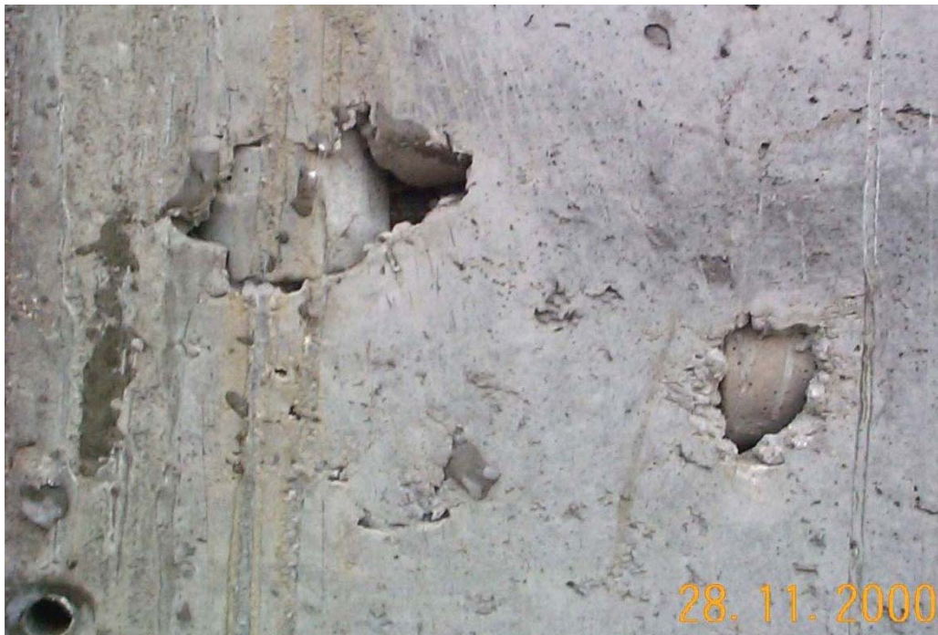
Рис. 5. Зависание бетонной смеси в зоне «сухарей»
