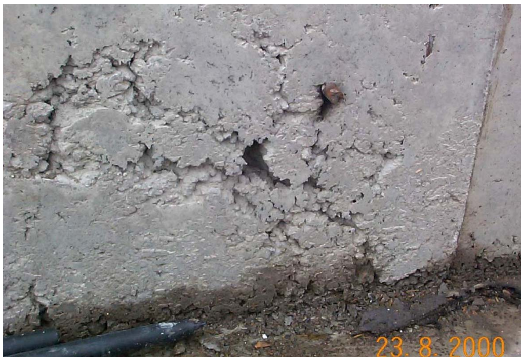
Рис. 4. Непровибрированные участки стены
